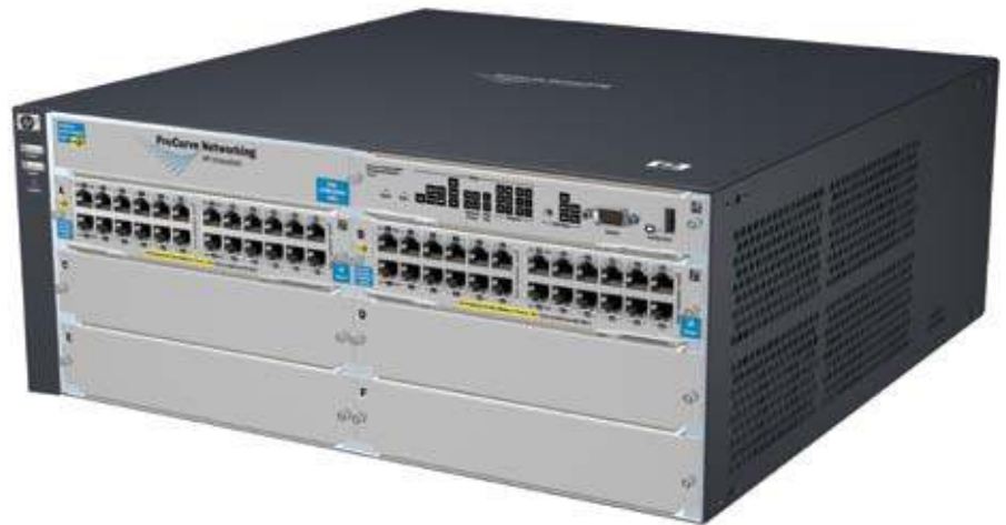
De managed switches die op de Universiteit Twente gebruikt worden zijn geen kleine consumentenswitches, maar grote 19" apparaten. Het zijn eigenlijk computers opzich die uitbreidbaar zijn door extra switchmodules toe te voegen.
